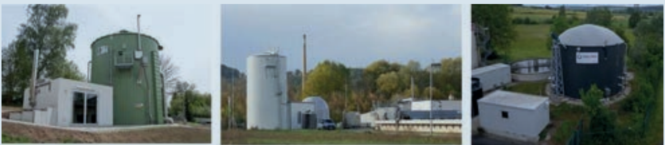
Bild 9: Beispiel kleiner Faultürme: KomBio-Reaktor (Faulbehälter und Gasspeicher in einem) mit 200 m 3 Faulvolumen – Lipp GmbH [9] (links), Arequa GmbH [10] (Mitte), Weltec Biopower GmbH [11] (rechts)
