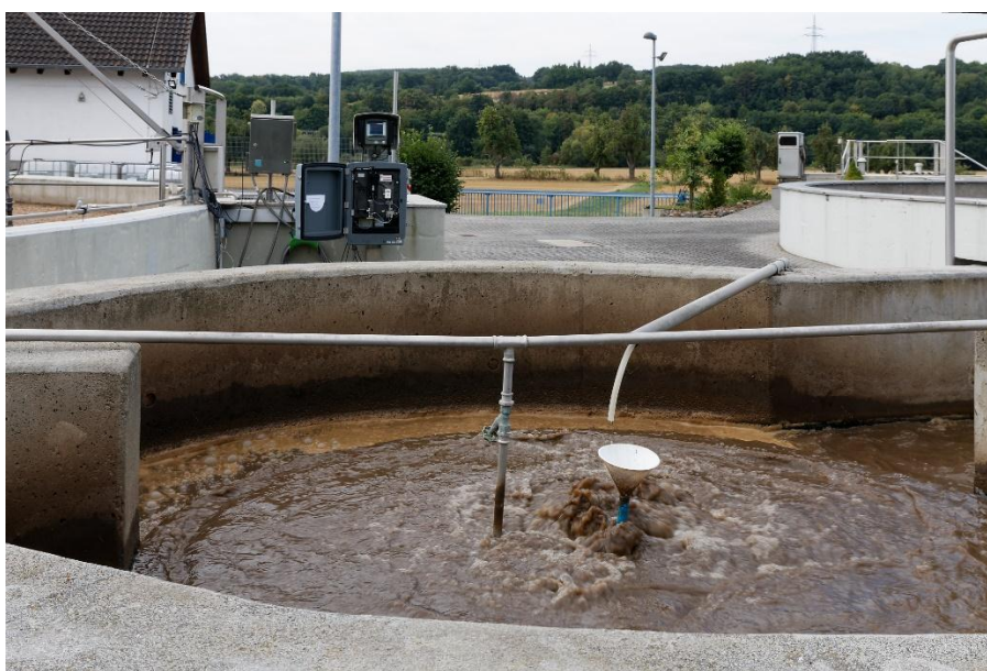
Abb. 1: Zweiter Dosierpunkt im Zulauf zum Nachklärbecken dahinter Ablauf Belebungsbecken mit Online-PO 4 -P-Analysator
